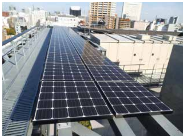
太陽光パネル（名古屋駅前ビル）
