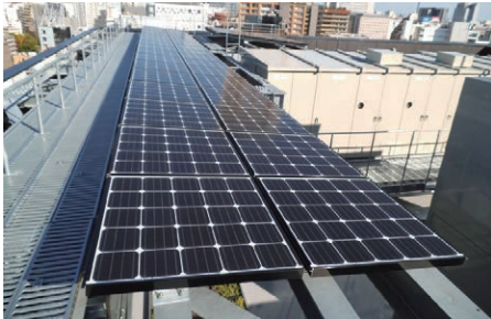
太陽光パネル（名古屋駅前ビル）
